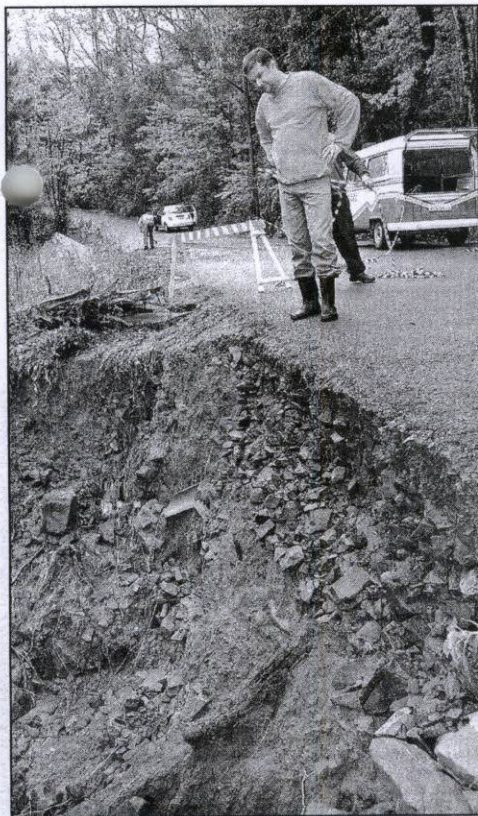
Água levou parte do barranco da estrada da Leopoldina
